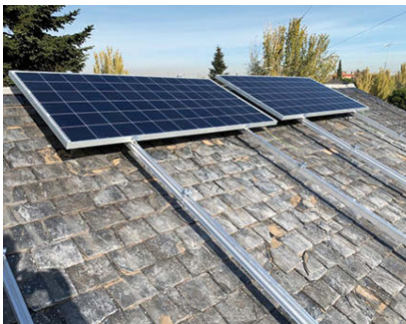
Paneles solares Remica.
